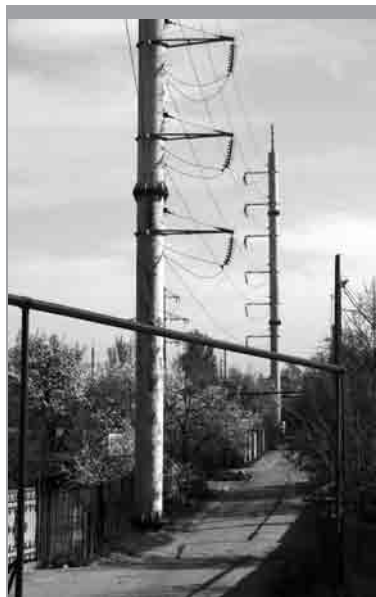
Опоры ВЛ 110 кВ, установленные на узких улочках микрорайона Горный Гигант. Фото 2007 года.
